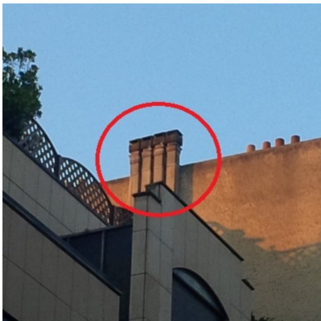
Conduits de ventilation en amiante-ciment (bâtiment mitoyen) au dessus des terrasses (Non Accessibles)
