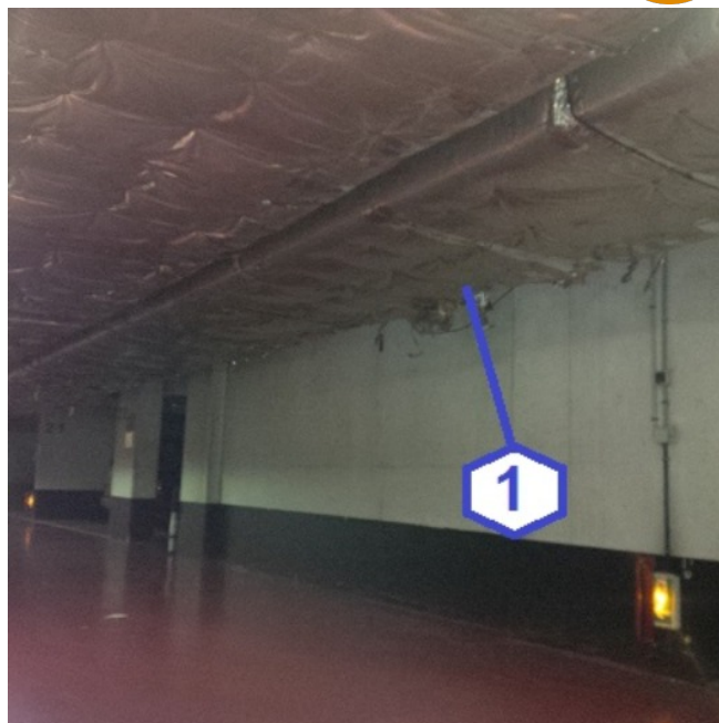
Parking 1er SSOL : Prélèvement calorifugeage aluminisé. Non Amianté.
