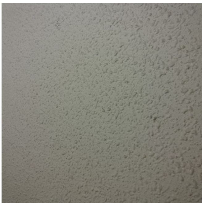
Peinture type "gouttelette" Non Amiantée.
